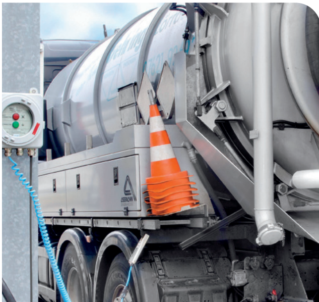
Mise à la terre active sur le camion-citerne
